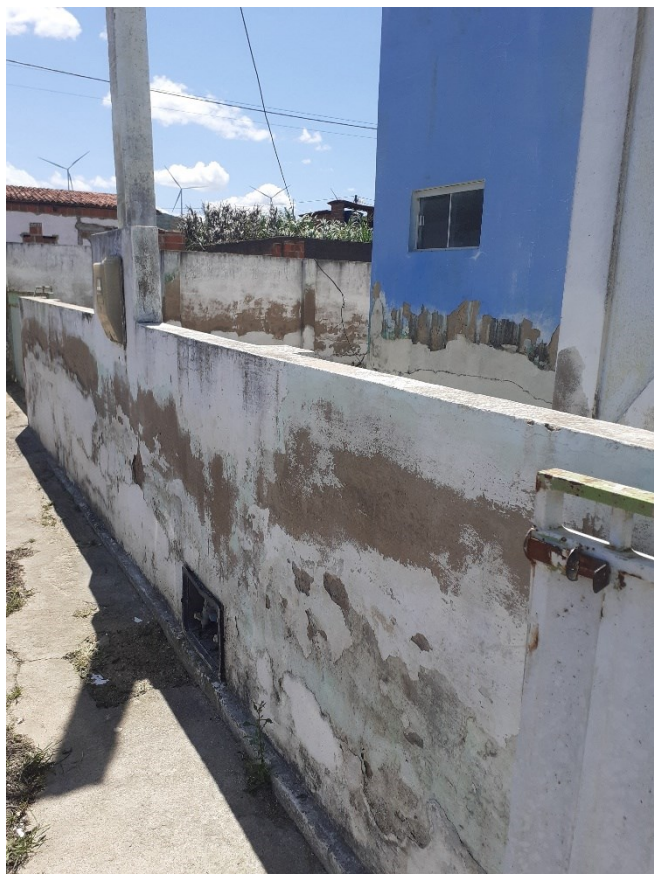
Área deteriorada no muro.
